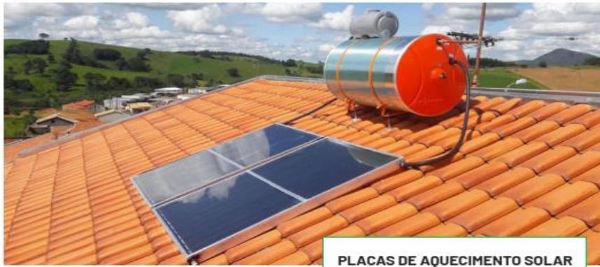
PLACAS DE AQUECIMENTO SOLAR
