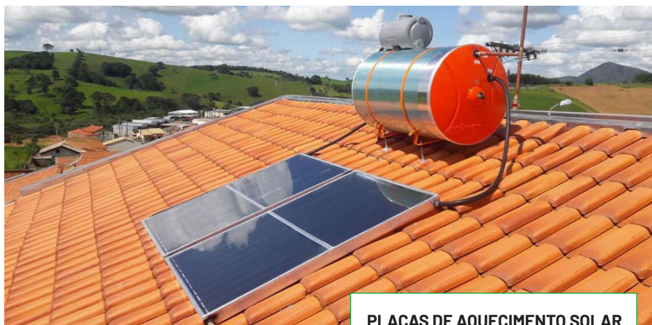
PLACAS DE AQUECIMENTO SOLAR
